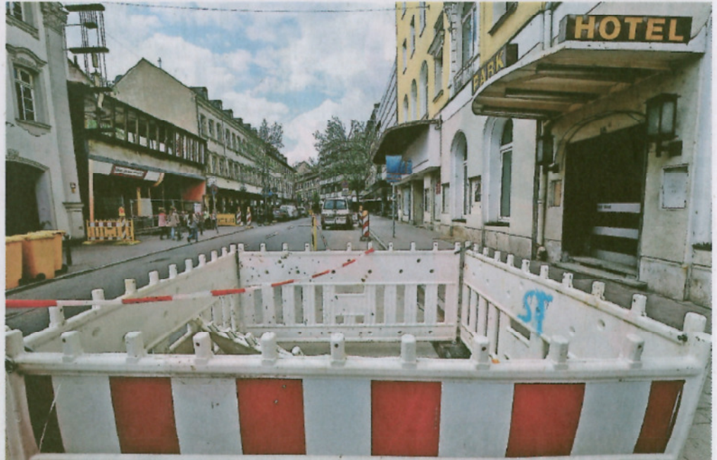
Die Vorfahrt einer riesigen Baustelle: In der Rudolf-Breitscheid-Straße geht der Investor MIB in die Vollen und setzt besonders dem früheren City-Kino (links) zu. Foto: Horst Linke
