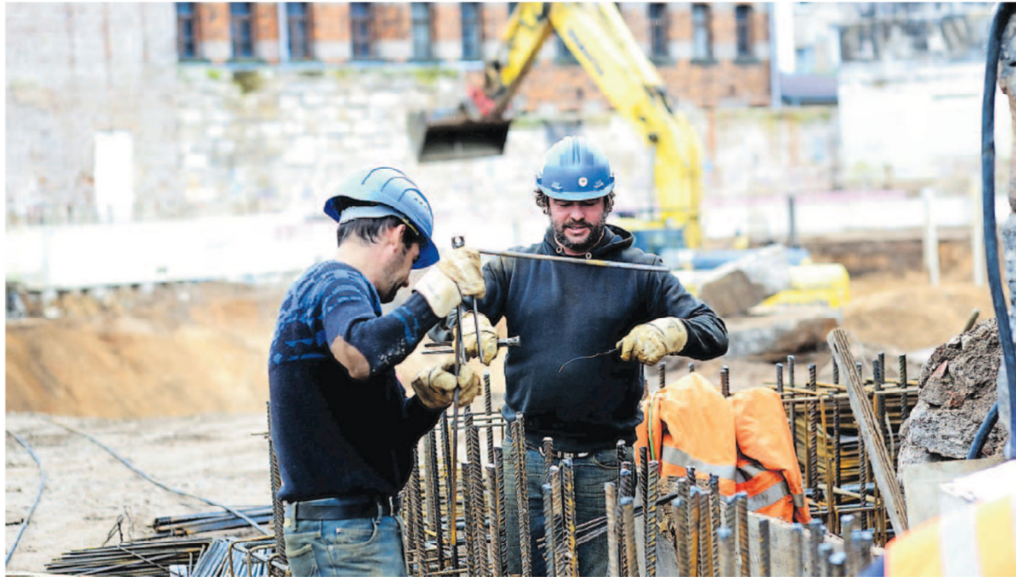
Während die Baugrube (im Hintergrund) immer tiefer wird, sind Arbeiter weiter mit der Absicherung der benachbarten Gebäude beschäftigt. Weil das Wölfel-Gelände von Häusern umgeben ist, musste die Baustelle aufwendig mit eng nebeneinander stehenden Bohrpfählen abgegrenzt werden. Foto: Hans-Joachim Winckler
