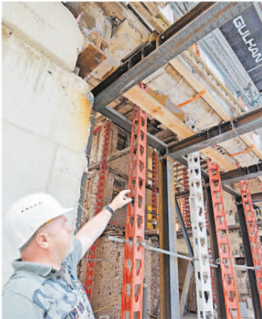
Nur auf Stahlträgern ruht aktuell die Hülle des Hauses, in das sOliver und das Café Samocca einziehen.
