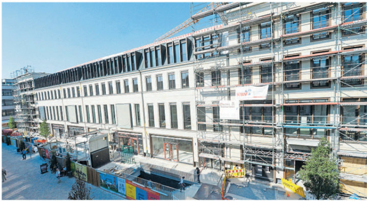
So sieht der Neubau also aus: Der Blick auf einen Teil der Fassade ist schon frei. Der gelbe Arm des Krans schwenkt nur noch haute darüber.
